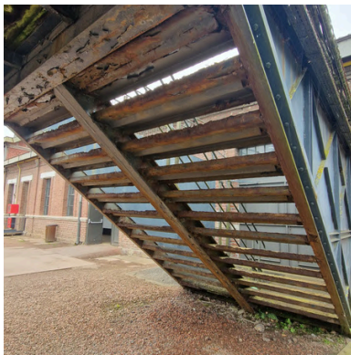
État dégradé de la passerelle des mineurs avant travaux
