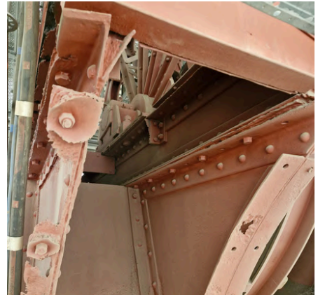
Vue de la dégradation des structures métalliques du chevalement
